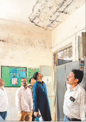
जर्जर स्कूल भवन का निरीक्षण करते हुए एवं स्कूल का क्षतिग्रस्त छत।
